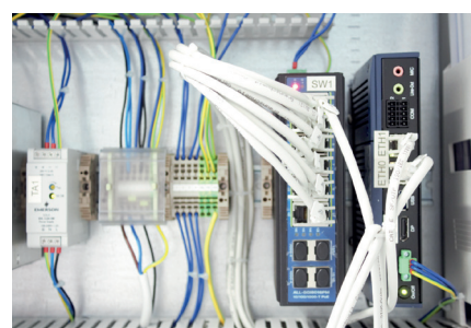
Rozwiązanie szafy sterowniczej firmy
