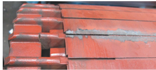
Rys. 7.13. Przerwane pręty powodują także wypalenie skrajnych blach wirnika
