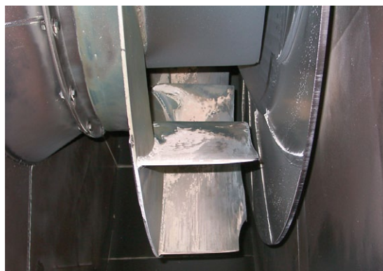
Rys. 18. Uszkodzony wirnik wentylatora powietrza
