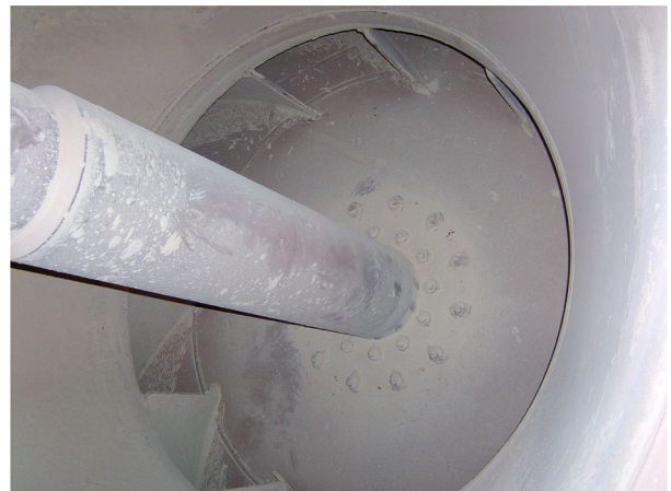
Rys. 15. Widok wirnika wentylatora
