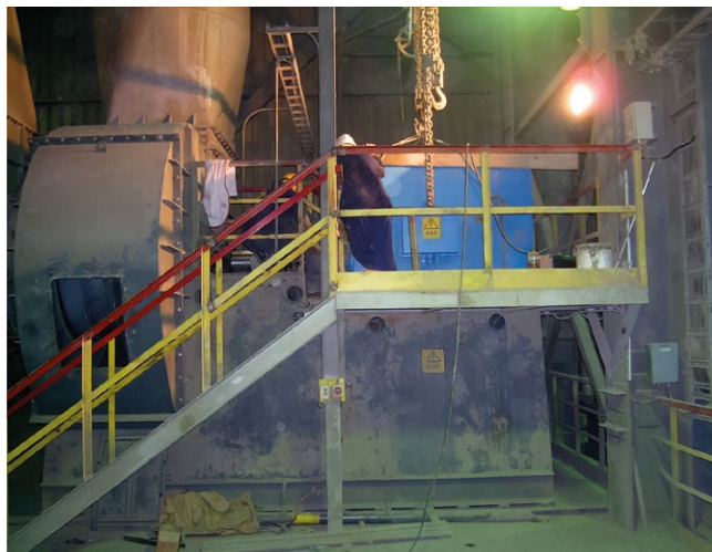
Rys. 16. Widok wentylatora powietrza wraz z sarkofagiem
