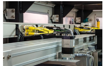
Fot. 2. Urządzenia IO-Link Master, koncentratory czujników i moduły bezpieczeństwa BNI IOF (żółte) firmy Balluff zostały umieszczone ponad poziomem układu, dzięki czemu są łatwo dostępne i nie stwarzają zagrożenia
