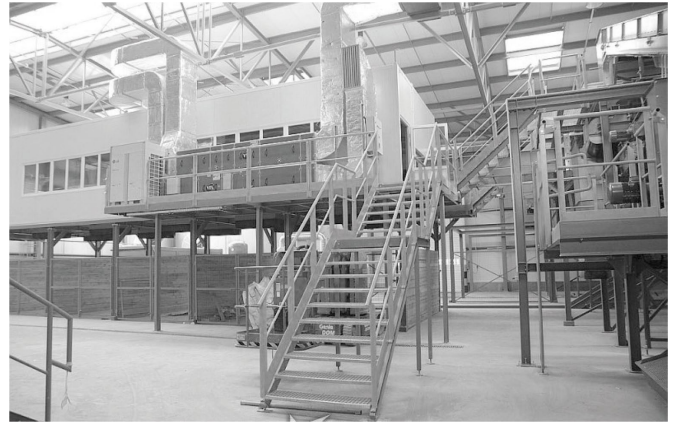
Rys. 3. Stacja segregacji odpadów
