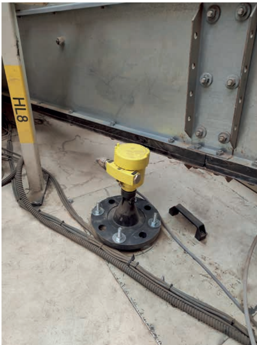
Zdj. 1: Dotąd planowanie nowej partii produkcyjnej było znacznie utrudnione, ponieważ w silosach były zainstalowane tylko sygnalizatory poziomu granicznego. Dzięki ciągłemu pomiarowi poziomu napełnienia firma Julius Meinl może planować procesy z większą precyzją.
