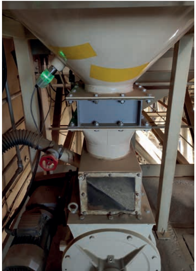
Zdj. 2: Obok sond do ciągłego pomiaru zawartości silosu zainstalowano również kilka sygnalizatorów poziomu granicznego VEGAPOINT 31. Mają one kontrolować stan pusty zbiorników buforowych.
